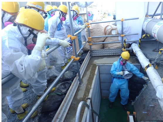
▲東京電力による凍土壁の説明
