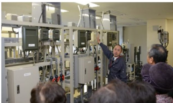
「まちめぐりバスツアー」における 小山浄水場の見学の様子
