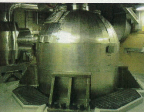
1号機残留熱除去系熱交換器
