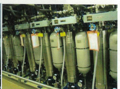
1号機水圧制御ユニット
