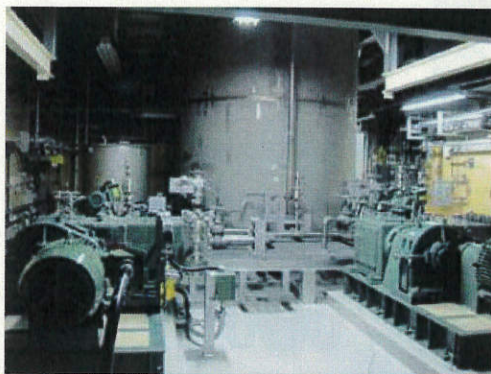
1号機ほう酸水注入系のタンクとポンプ
