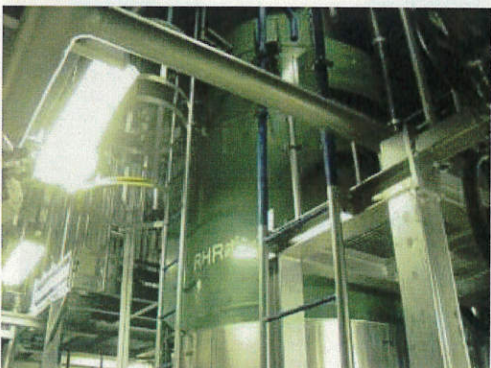
1号機残留熱除去系ポンプ
