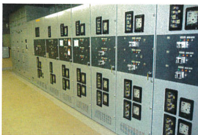
1号機 電源盤 (P/C 1C-1) 据付後
