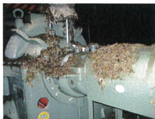
津波によるポンプの被水状況
