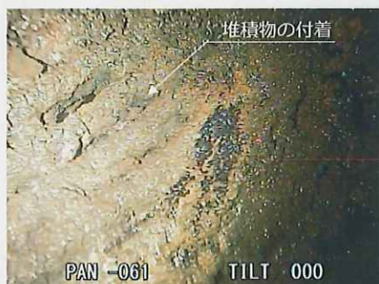
撮影場所A グレーチング脱落部②
