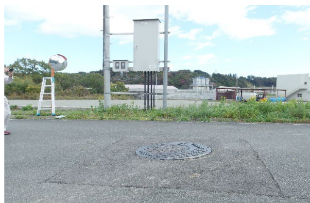
▲第7中継ポンプ場（檜葉町大字前原作助） （供用開始：1998（平成10）年度）
