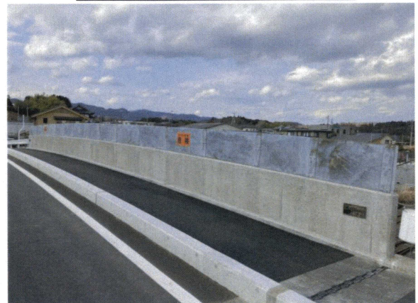
投物防止柵(歩道側)
