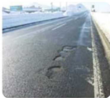
路面の穴ぼこ・ 段差
