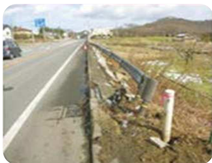
ガードレール・ 標識等の損傷
