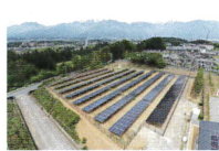
リユース品を使用した発電所
