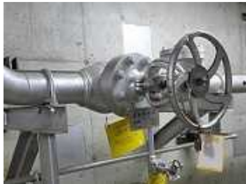
<対象弁の隔離措置>
