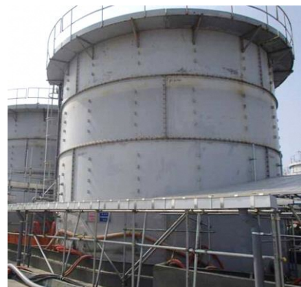
フランジ型タンク （東電 HD ホームページより）
