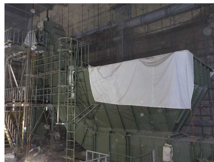
②Ⅲ工区 主要設備設置状況（廃棄物供給装置）
