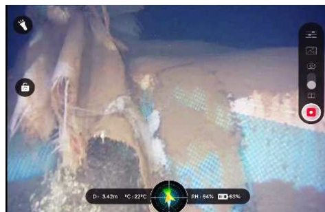
破損している土嚢
