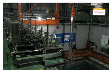
オペレーティングフロアの様子
