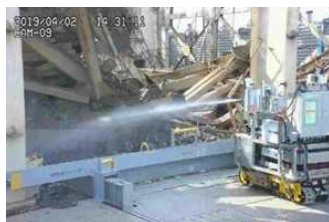
局所散水状況
