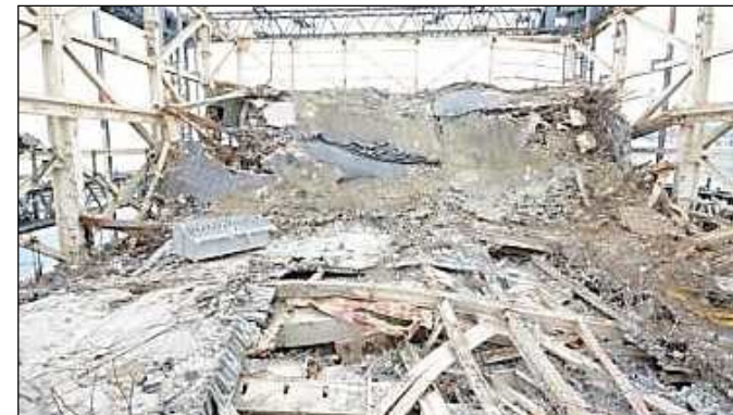
崩落屋根の状況
