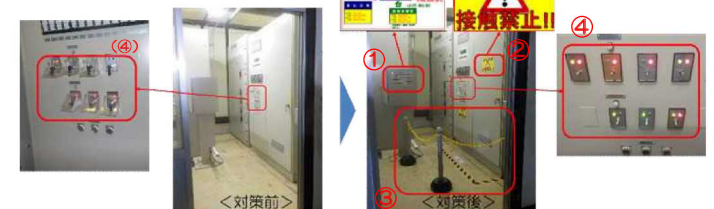
原子炉注水設備制御盤 B)
