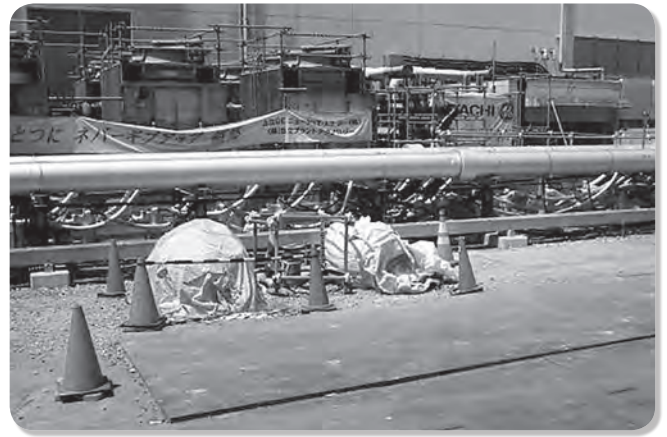
凍土遮水壁設備
